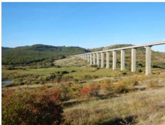
(a) Corpo di frana lungo la spalla del viadotto.
