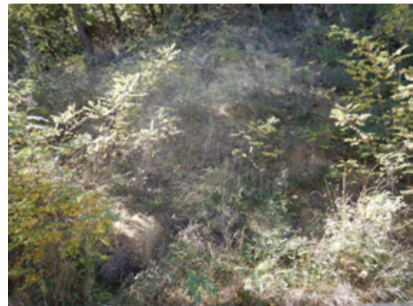
(b) Scoscendimento superficiale lungo la tratta ferroviaria.
