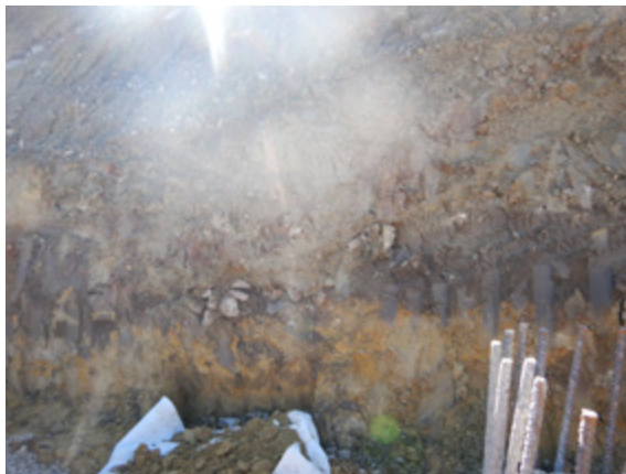
(a) Contatto tra corpo di frana e terreno in posto.
