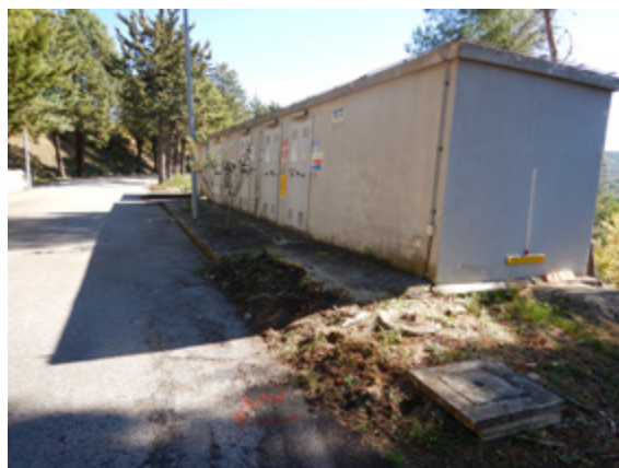
(b) Cabina elettrica.
