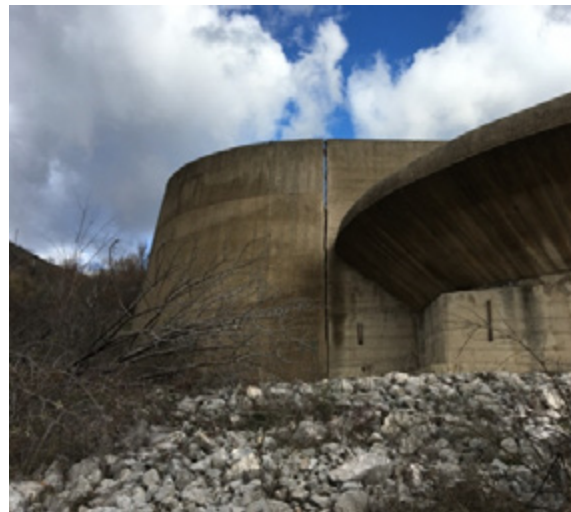
(b) Muro lesionato.
