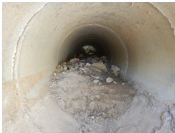
(d) Condotta delle acque occlusa a causa del dissesto.
